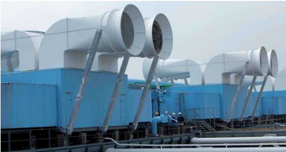
Les centrales de traitement d'air sur le toit du Centre Pompidou © Centre Pompidou / photo H. Véronèse
