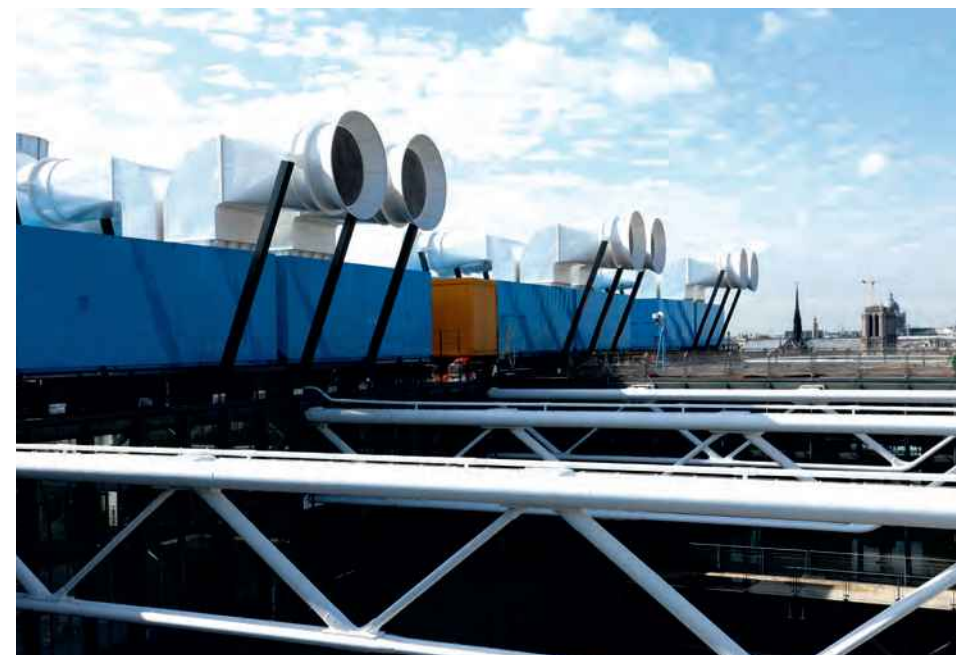
Vue des centrales de traitement d'air sur la terrasse du Centre Pompidou © Centre Pompidou, MNAM-CCI. Photo Hervé Véronèse
