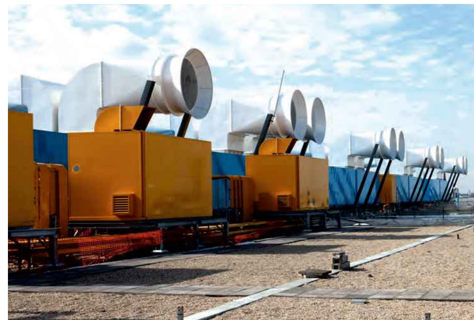
Vue des centrales de traitement d'air sur la terrasse du Centre Pompidou © Centre Pompidou, MNAM-CCI. Photo Hervé Véronèse
